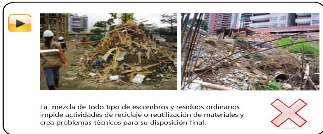
Figura 6. Inadecuada clasificación de residuos
