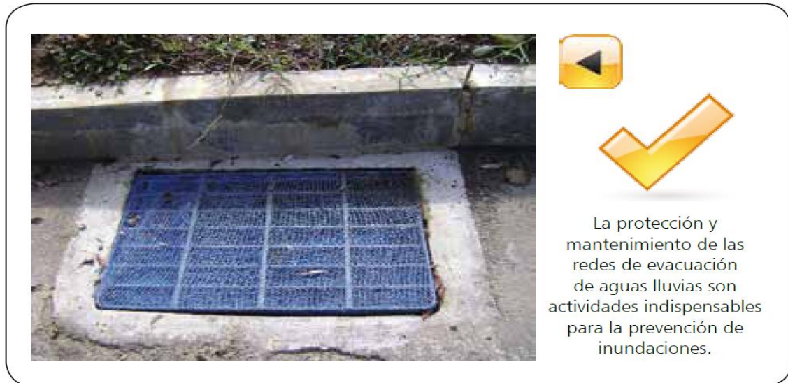
Figura 23. Manejo adecuado de las redes de aguas lluvias.
